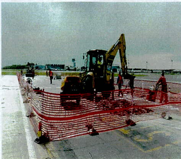
Sursa: CNAB SA (Platforma 2 înainte de reparații curente)
