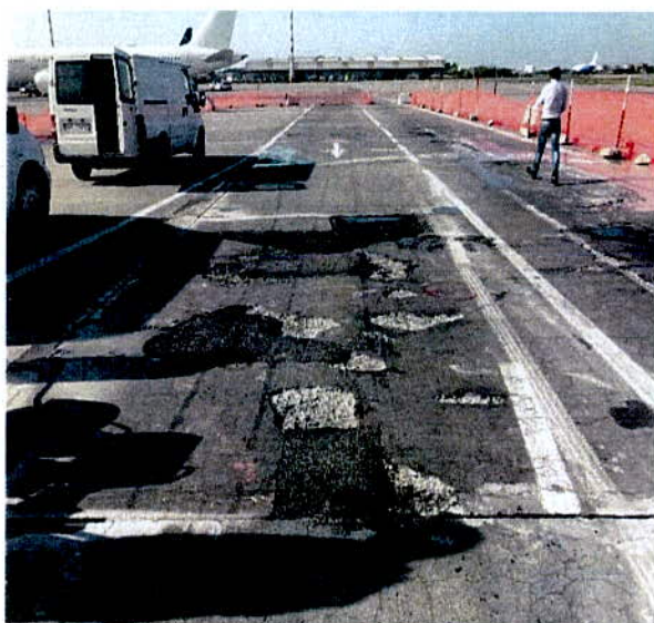
Sursa: CNAB SA (Platforma 1 înainte de reparații curente)
